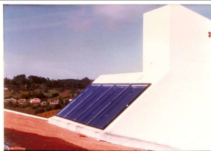
Integração do sistema solar na cobertura
